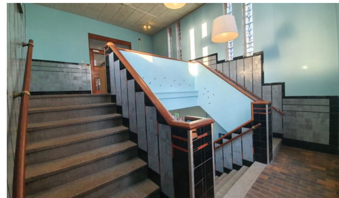
Het nog originele trappenhuis van basisschool 'De Saenparel' in de Rosmolenbuurt, gebouwd in 1930 en een potentieel gemeentelijk monument
